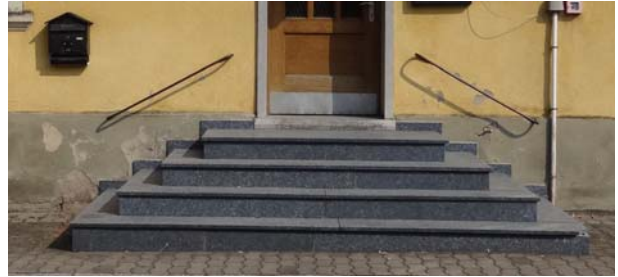
Passende Stufenform, falsches Material zum Sandsteinhaus
